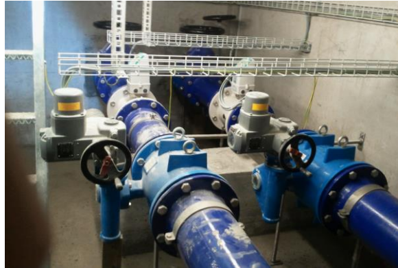
Vannes de dotation automatiques pour l'eau brute
