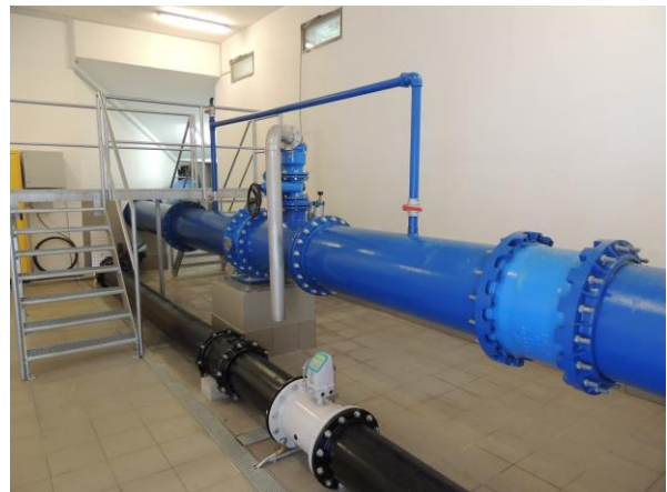
Vanne de survitesse à contrepoids et bypass de remplissage
