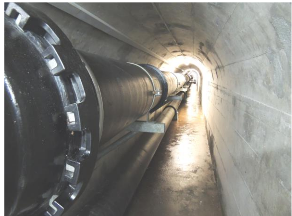
Conduite DN500 sur supports métalliques et DN300 sur socles béton
