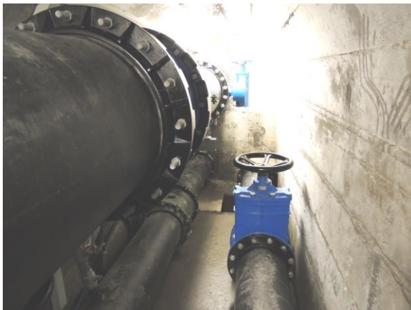
Vannes de garde au fond de la galerie de la digue
